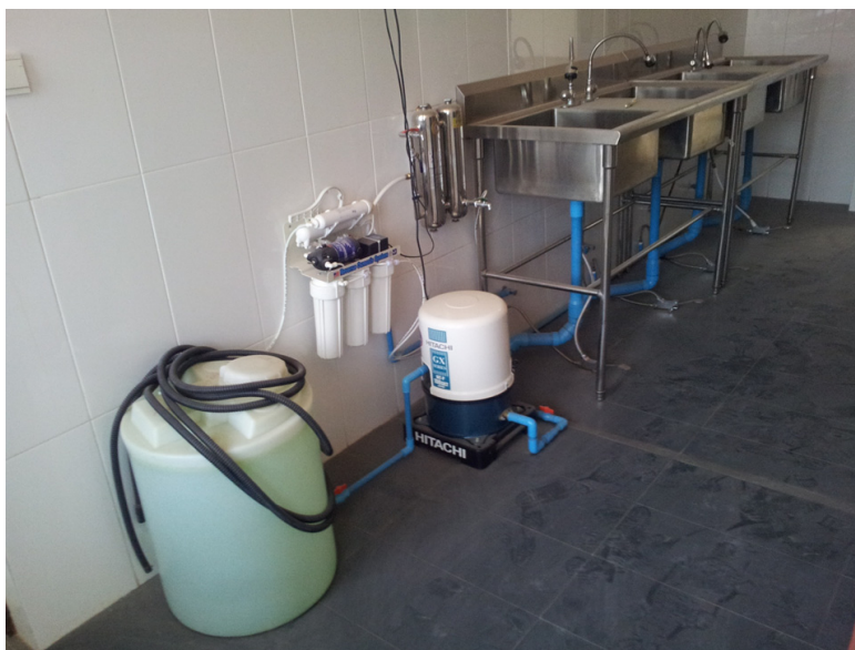
[그림 10] 라오스 아동병원 수술실 손세척기 가압 및 정수 설비
