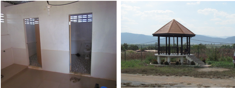
<사진 4-11. 수요를 추가 반영하여 설치된 화장실과 휴식시설>
